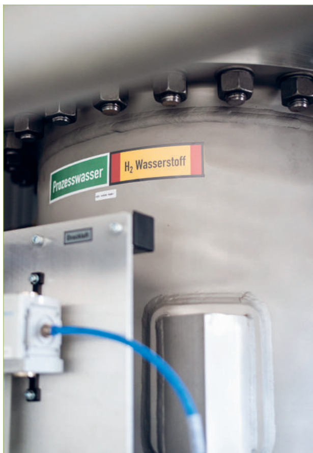
Überschüssiger Strom lässt sich – wie hier per Elektrolyse – auch speichern und für die Wärmeversorgung nutzen.
